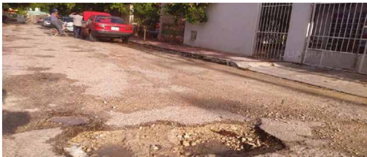
Figura 2. Calles del fraccionamiento con baches
